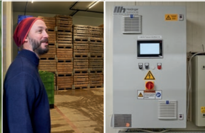
Die ganze Technik im Blick: Vor Ort am Display und aus der Ferne per DFÜ/Fernwirktechnik.
