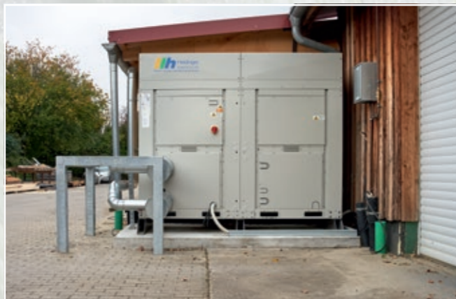
Zentrale, bivalente Luft-Wasser-Wärmepumpe im Außenbereich.
